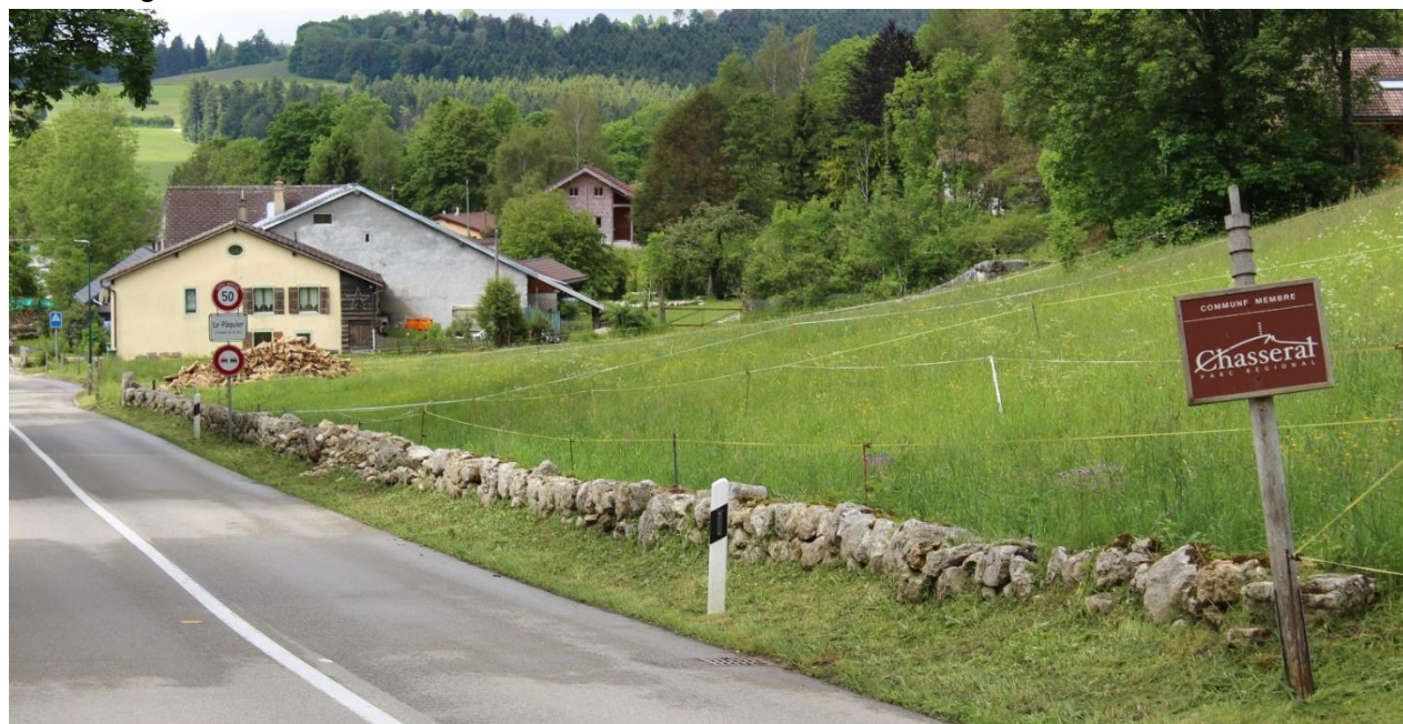
Figure 8 : Partie du mur existant en mauvais état. le 12.06.2019
